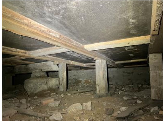
Mikrobiell påväxt på blindbotten i krypgrunden samt organiskt material som finns på marken.
