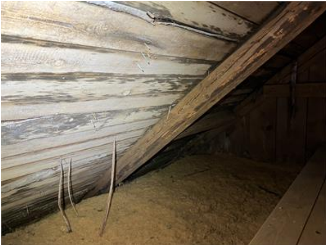
Mikrobiell påväxt finns på vinden vilket regelbundet bör kontrolleras för ev förändringar.
