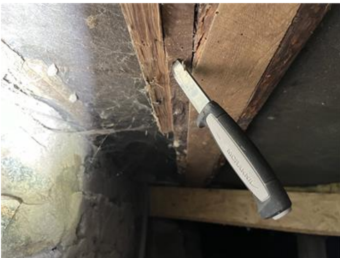
Lokala rötskador förekommer i krypgrunden, rimligen äldre. Ej helt genomgående.
