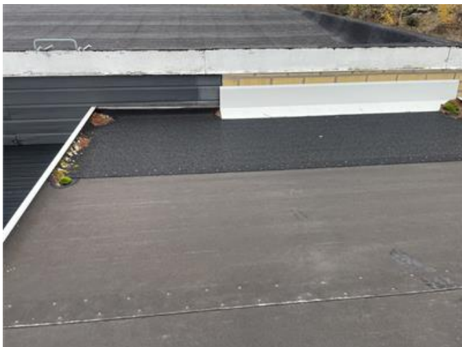
Entretak med saknat beslag
